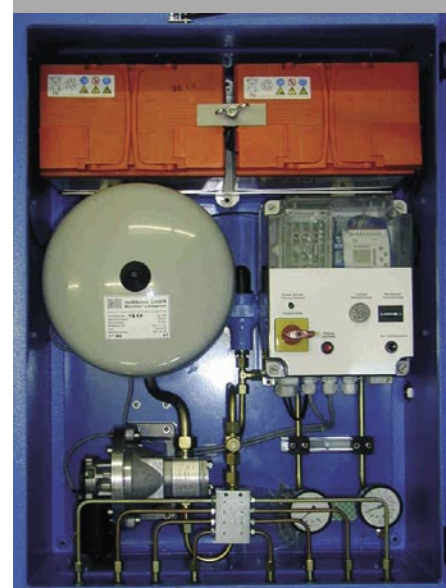
Energievoorziening met batterijpak
